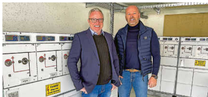
V.l.n.r.: Michael Brendel und Thorsten Ruprecht in der neuen 20 kV-Schaltanlage auf dem Stadtwerke-Gelände.
