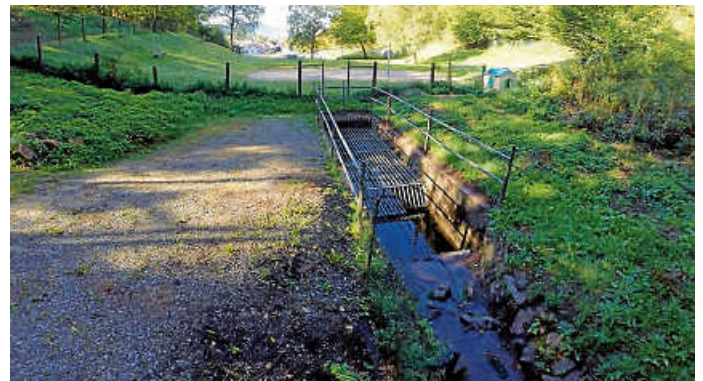
Problematisch: der jetzige Einlauf in die Verdolung. Foto: Wald&Corbe
