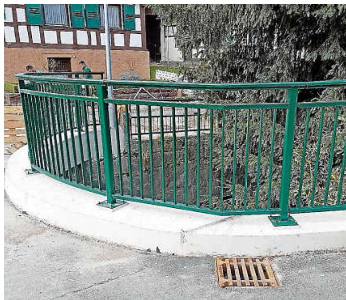
Das Betonschrammbord bringt zwar mehr Sicherheit - entspricht aber nicht den denkmalrechtlichen Vorgaben.
