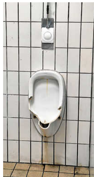
Das Urinal ist nicht mehr nutzbar. Foto: Stadt Gaggenau
