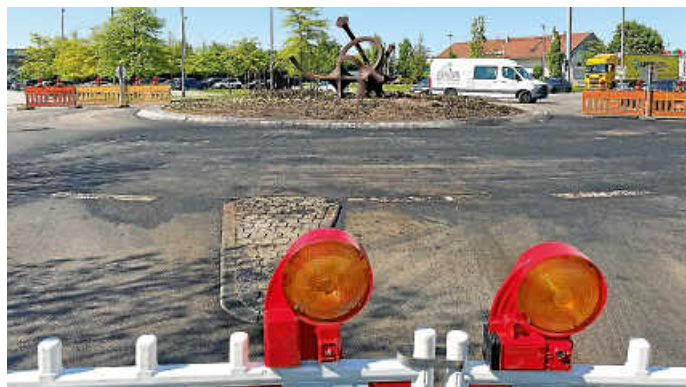
Stark beschädigt wurde der Asphalt durch den Brand.
