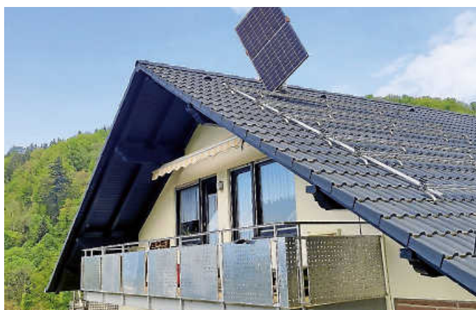
Photovoltaik im Murgtal.
