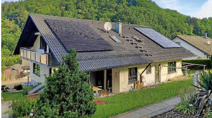
Strom erzeugen auf dem eigenen Dach.
