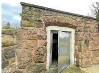
Der Hochbehälter ist nahe der Bushaltestelle Sommerhalde zu finden. Foto: Stadtwerke Gaggenau
