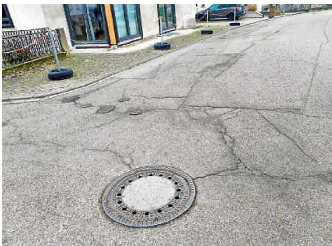
Der Fahrbahnbelag in der Ottenauer Straße muss erneuert werden. Foto: Stadt Gaggenau
