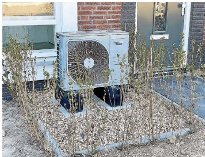
Der Standort der Wärmepumpe sollte im Vorfeld schon geklärt werden.
