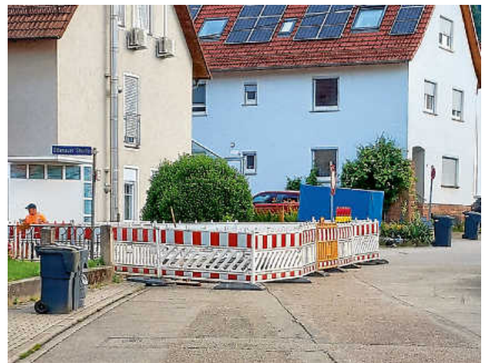
Das Betreten der Baustelle ist verboten, weil gefährlich.
