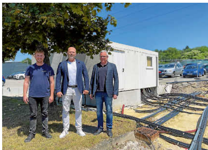
Sebastian Ade, Thorsten Ruprecht und Michael Brendel vor der neuen 20 kV-Schaltanlage der Stadtwerke.
