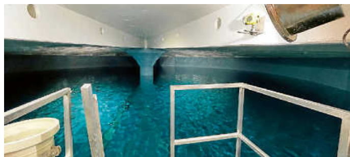
Kostbares Trinkwasser im Hochbehälter Erlich.
