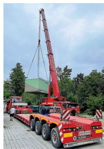
Bereits 2021 aufgestellt: Das POP-Gebäude im Wiesenweg. Foto: Stadtwerke Gaggenau
