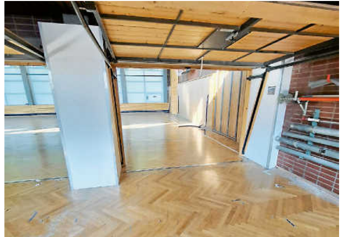
Der Geräteraum ist leer geräumt.
