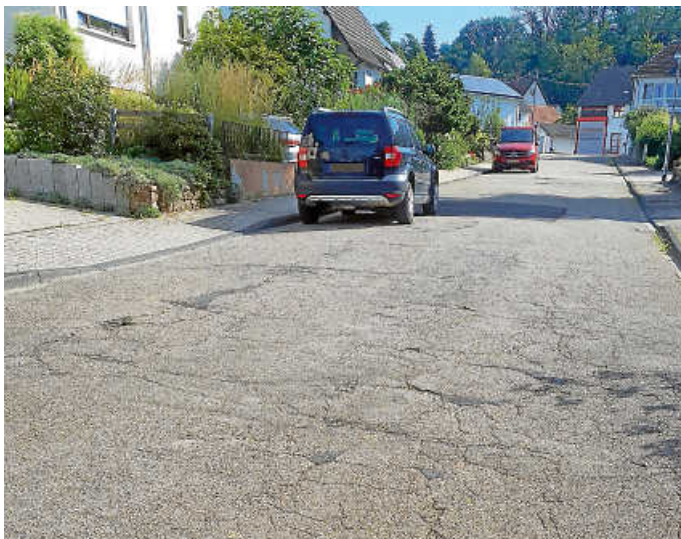
Neben den Kanälen ist auch die Straßendecke sanierungsbedürftig. Foto: Stadt Gaggenau
