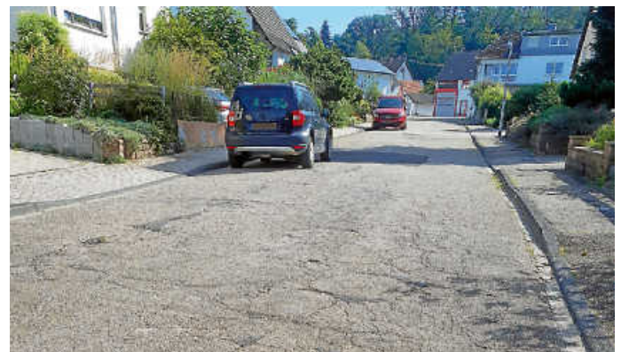
Neben den Kanälen ist auch die Straßendecke sanierungsbedürftig.
