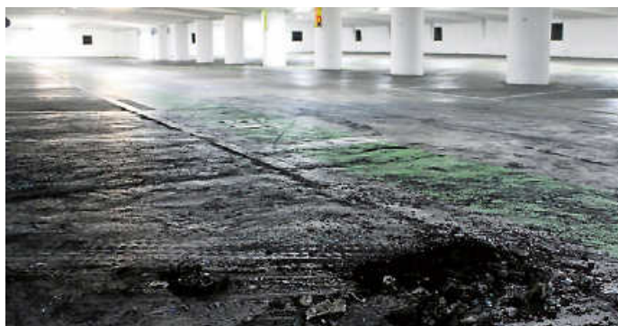
Die Folgen des Brands in der Tiefgarage.
