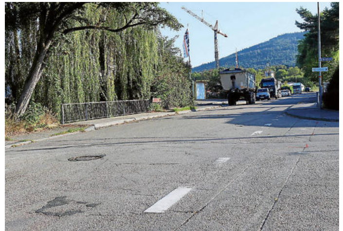
Die Brücke ist sanierungsbedürftig.
