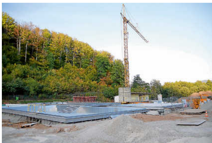
Blick auf den technischen Badbereich.
