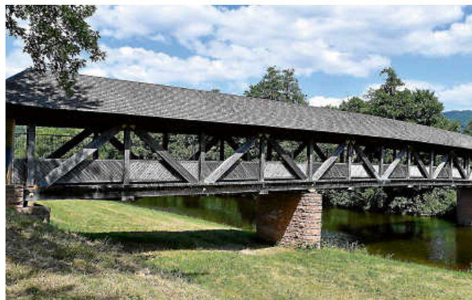
Ab Montag ist die Holzbrücke gesperrt.
