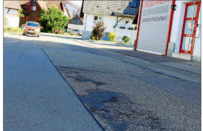
Die Schäden in der Freiburger Straße sind nicht zu übersehen.
