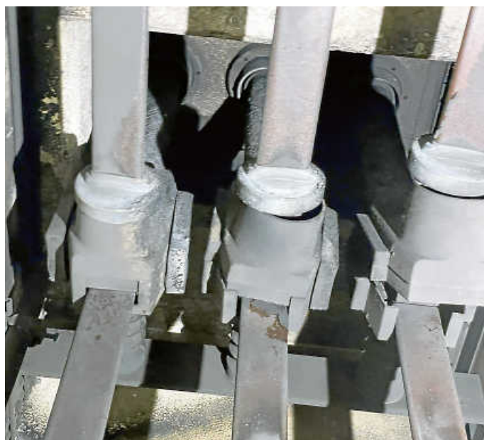
Das Bild zeigt einen Ausschnitt der beschädigten Schaltzelle.
