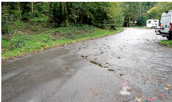
Der Fahrbahnbelag muss erneuert werden. Foto: Stadt Gaggenau
