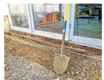
So sah der Schaden im Sommer am Sockel aus.
