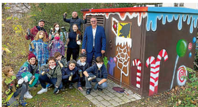
Wie ein Lebkuchenhaus haben die Jugendlichen diese Trafostation gestaltet. Foto: Stadtwerke
