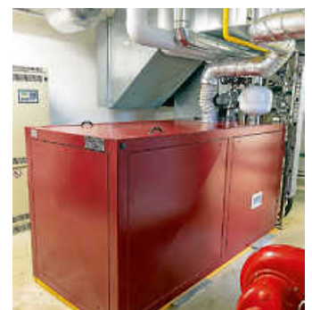
Foto: Stadtwerke Gaggenau.
