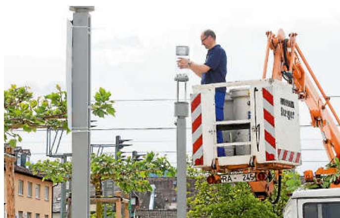
Defekte Straßenlaternen werden tagsüber repariert.
