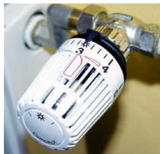
Eine effiziente Heizanlage hilft beim Kosten sparen.
