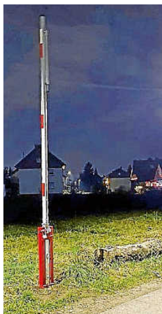
Die neue Schranke ist installiert und wird nach den Feiertagen in Betrieb genommen.
