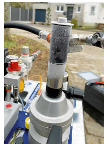
Frost an Bauteilen des Einblasgerätes bremst den Glasfaserausbau. Foto: Stadtwerke Gaggenau
