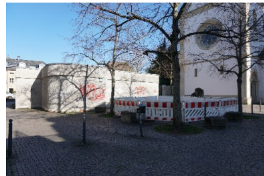
Abbildung 47: Sanierungsbedürftige Toilette mit Brunnen und umgebendem öffentlichem Raum (Quelle: WHS, 2025)
