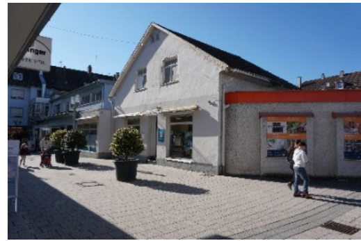
Abbildung 39: Gebäude mit erheblichen substanziellen Mängeln in der Bahnhofspassage 1 (Quelle: WHS, 2025)
